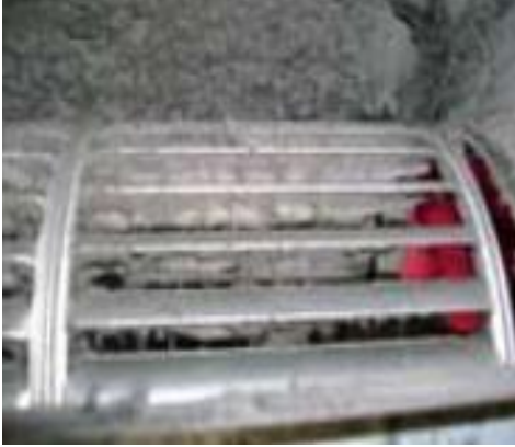
Turbine de ventilateur encrassée
