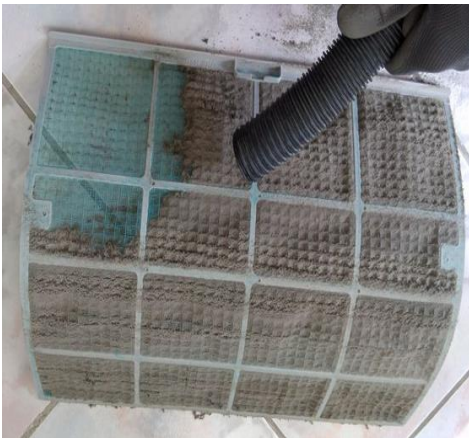
Filtre d'unité de climatisation en cours de nettoyage
